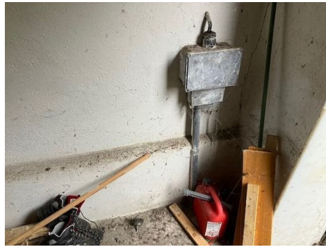
ELT Einspeisung im Haus
